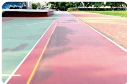
▲美育館與操場間的路面嚴重龜裂。
